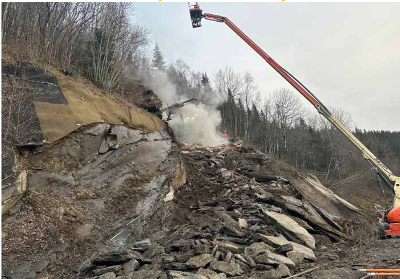
Fra opprydding og terrengsikring etter raset på Nordlandsbanen ved Bjerka 24. oktober 2024. Foto: Jan Olav Waag, Bane NOR
