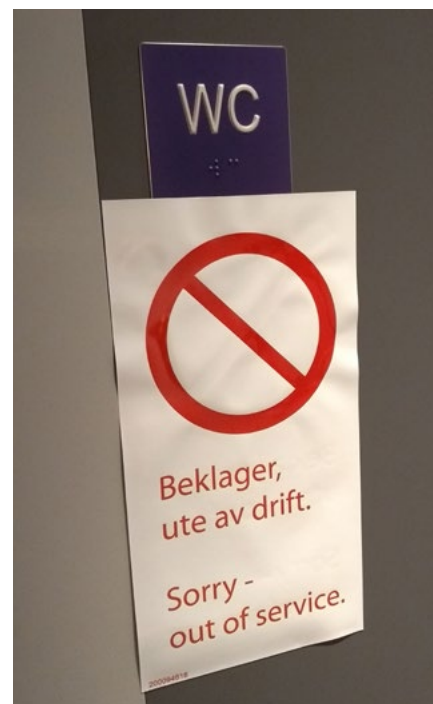
Tog-WC ute av drift - ikke helt sjeldent! - Også en teknisk installasjon som må holdes ved like, som koster penger, som det kanskje kan knipes på i anbudskonkurransen? Foto: For Jernbane
