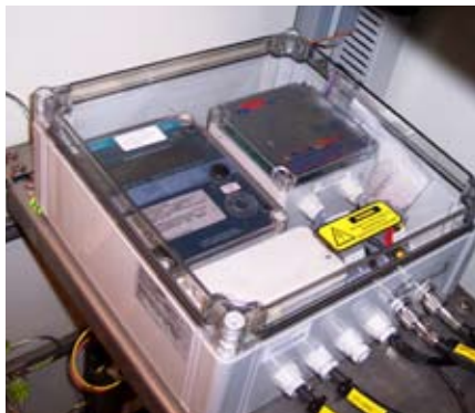
Strømmåleren som er montert i loket, foto JBV
